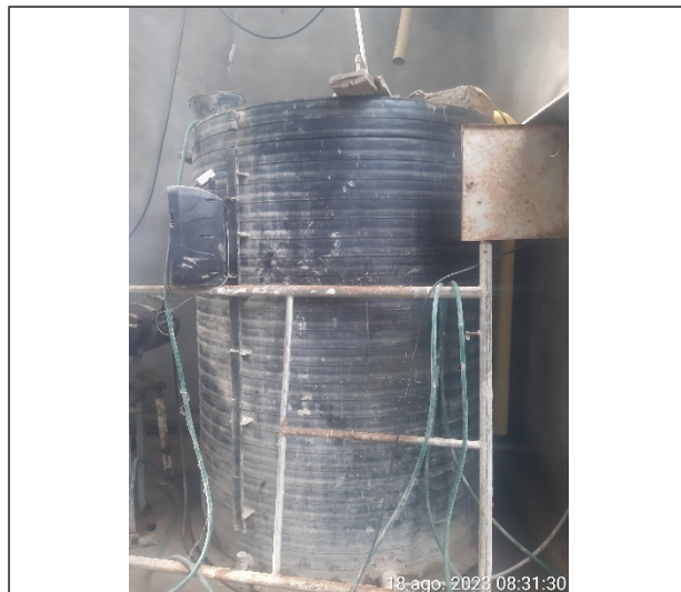
Fotografía No. 3 Motobomba y tanque
